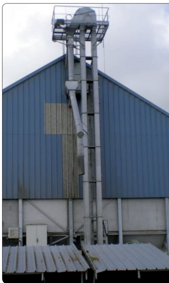
Élevateur situé en extérieur
