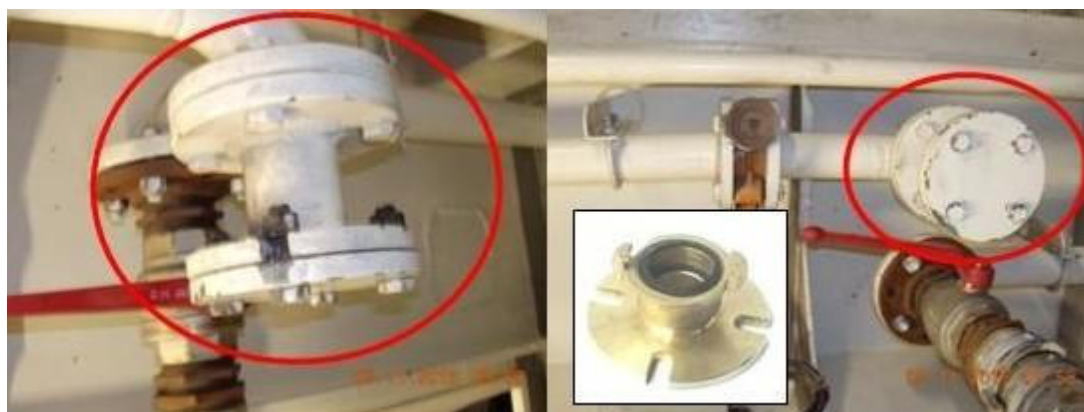
Vanne à détapier pour permettre l'alimentation du collecteur incendie par une source extérieure.
