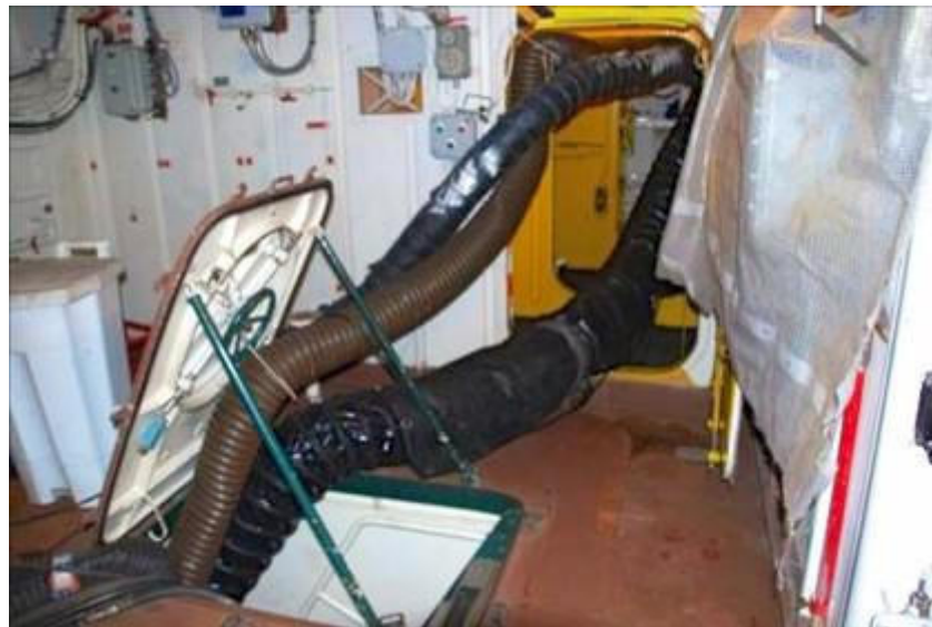
Coursive obstruée de navire en arrêt technique
