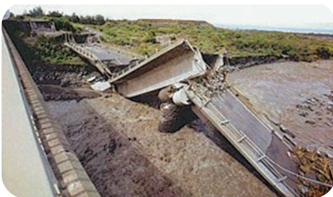
Pont détruit suite au passage du Cyclone Gamède à la Réunion. Source : Internet
