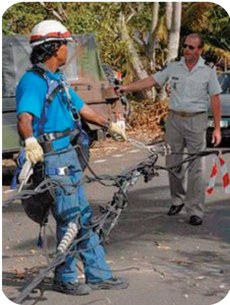
Rétablissement de lignes électrique suite au passage du cyclone Dean à la Martinique. Source : EDF
